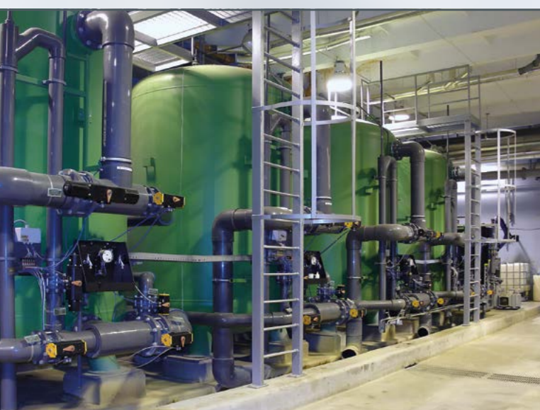
Kontinuierlich durchströmte Adsorber in einer Wasserbehandlungsanlage
