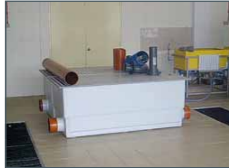
Wasserbehälter und Verrohrung
