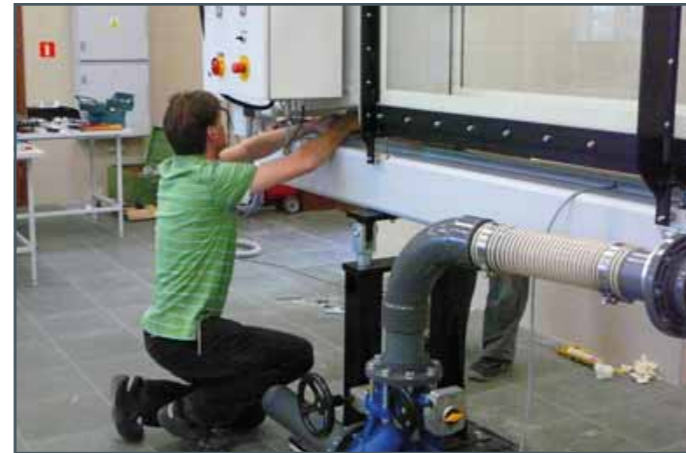
Letzte Arbeiten an der elektrischen Installation (links). Danach wird der Wasserbehälter ausgerichtet und mit dem Rohrleitungssystem verbunden (rechts).
