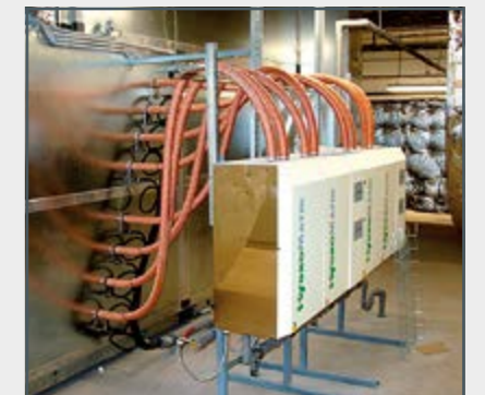
Dampf- und Lufterwärmer
