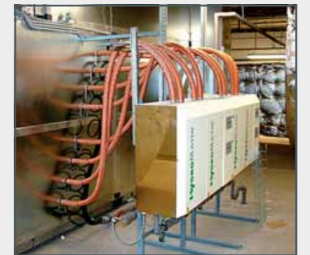
Dampf- und Lufterwärmer
