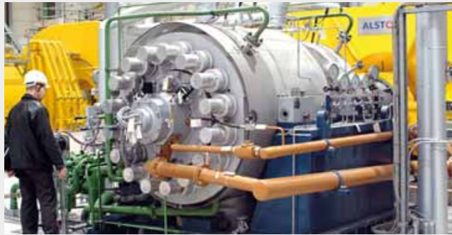
Kreiselpumpe eines Kraftwerks
