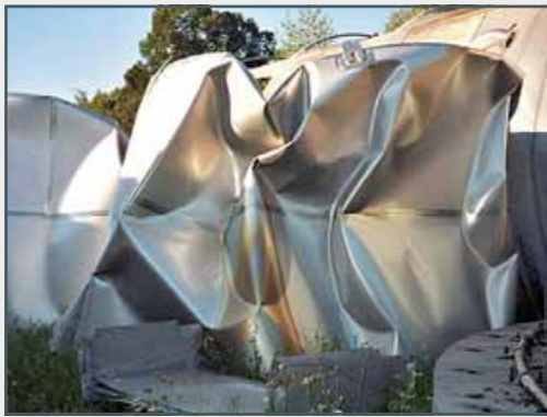
Kollabierter Behälter infolge eines Druckstoßes
