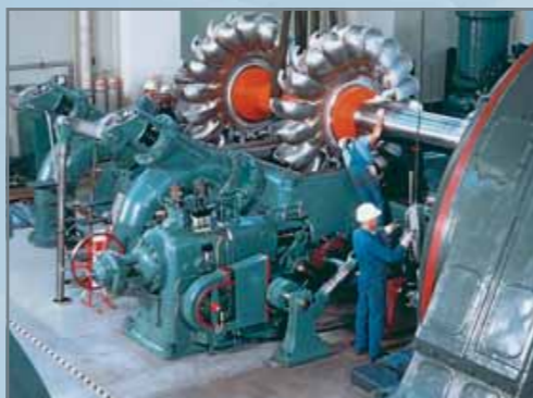
Montage d'une turbine Pelton dans la centrale électrique de Walchensee, Allemagne (Voith Siemens Hydro Power)
