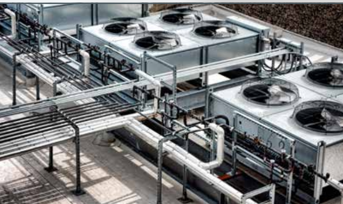
Condenseur dans un réseau de conduites d'agent réfrigérant
