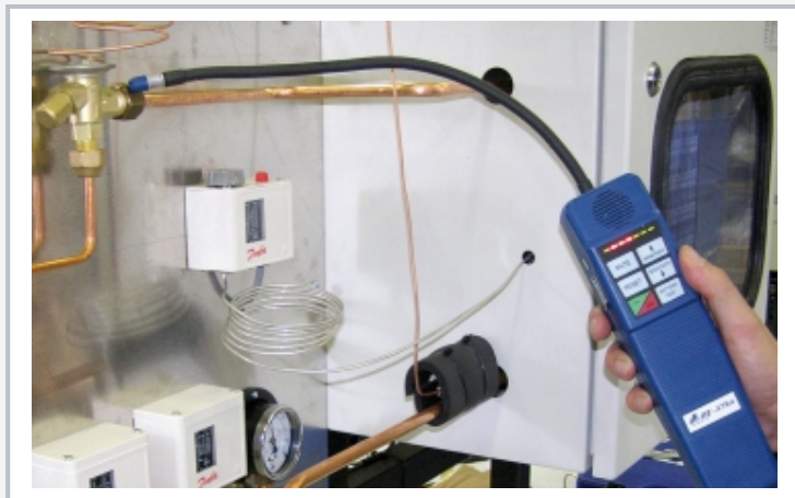
Contrôle d'étanchéité sur la soupape de détente de l'installation entièrement montée
